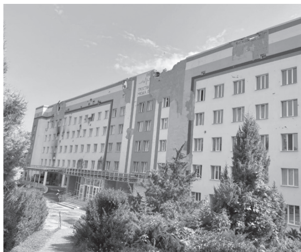
Рис. 2. Пошкодження на фасаді Тростянецької міської лікарні (серпень 2022 року) [11]
