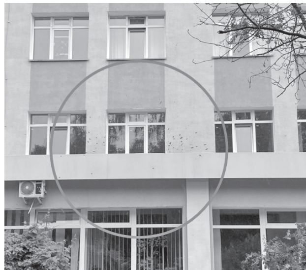
Рис. 4. Пошкодження на фасаді Чернігівської обласної дитячої лікарні, отримані після удару ракети з касетними боєприпасами 17 березня 2022 року. Фото зроблене в липні 2022 року [15]
