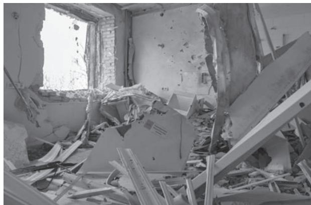
Рис. 1. Зруйнований амбулаторний корпус Тростянецької міської лікарні (вигляд ізсередини) [11]
