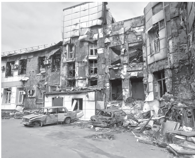
Рис. 6. Зруйнований корпус Маріупольської міської лікарні № 1 [19]
